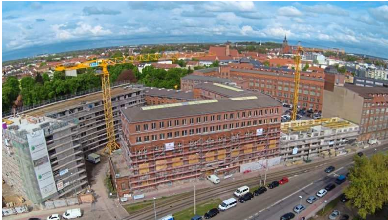
Aktuelles Großprojekt der Schomaker Baugruppe: Der Bau eines Bürokomplexes in Brandenburg. Foto: Baugruppe Schomaker
